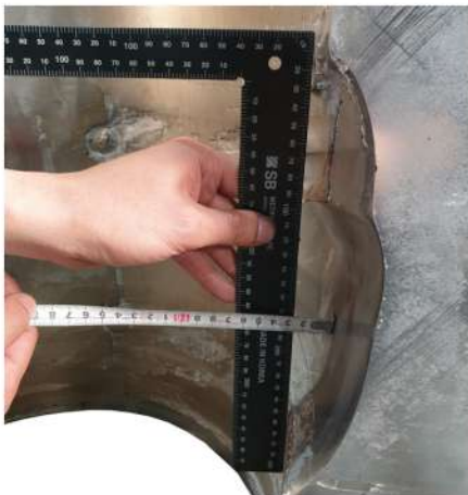
마모 깊이 측정
