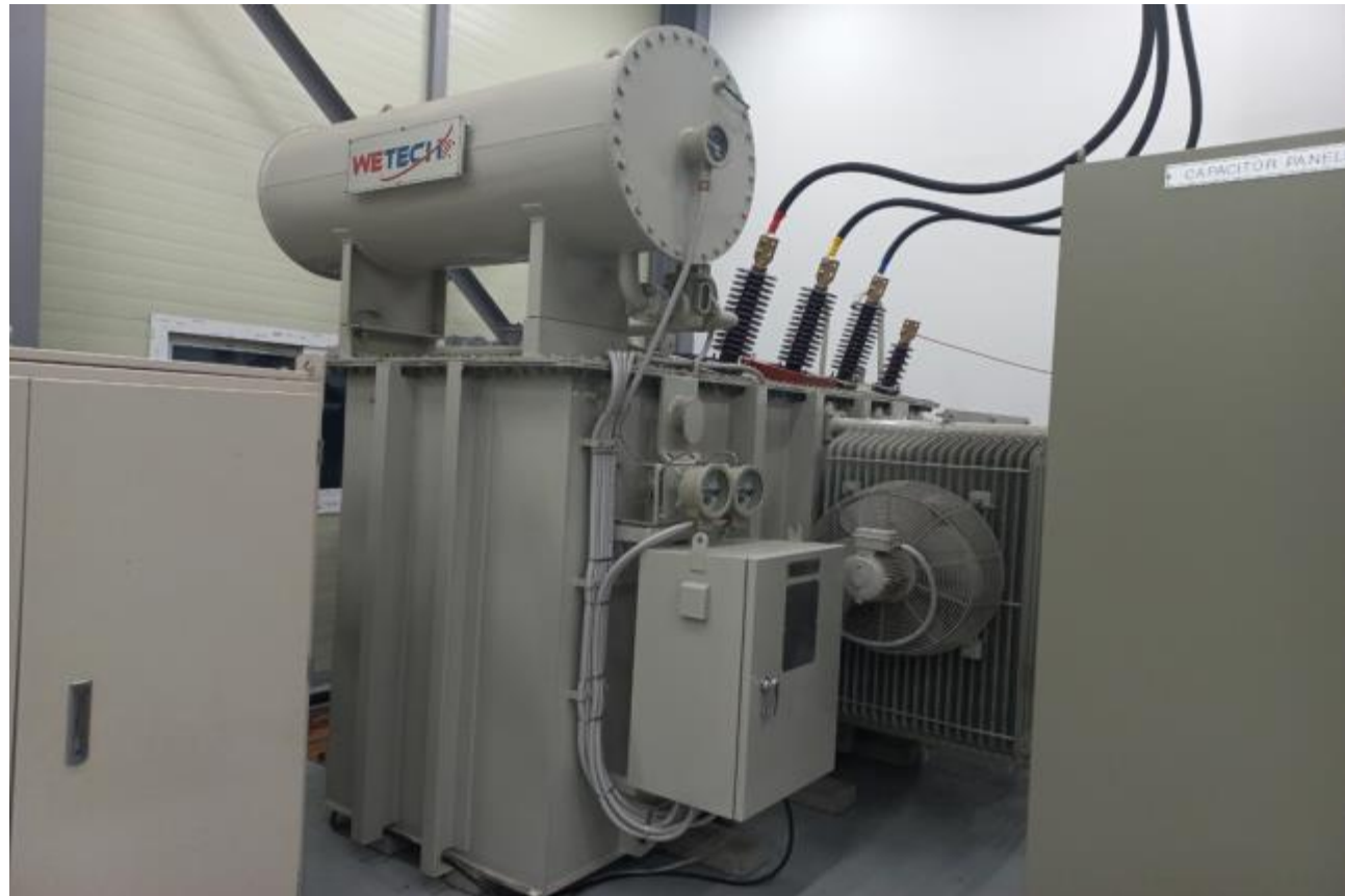
-시험용 보조 변압기 2500kVA OCTC
